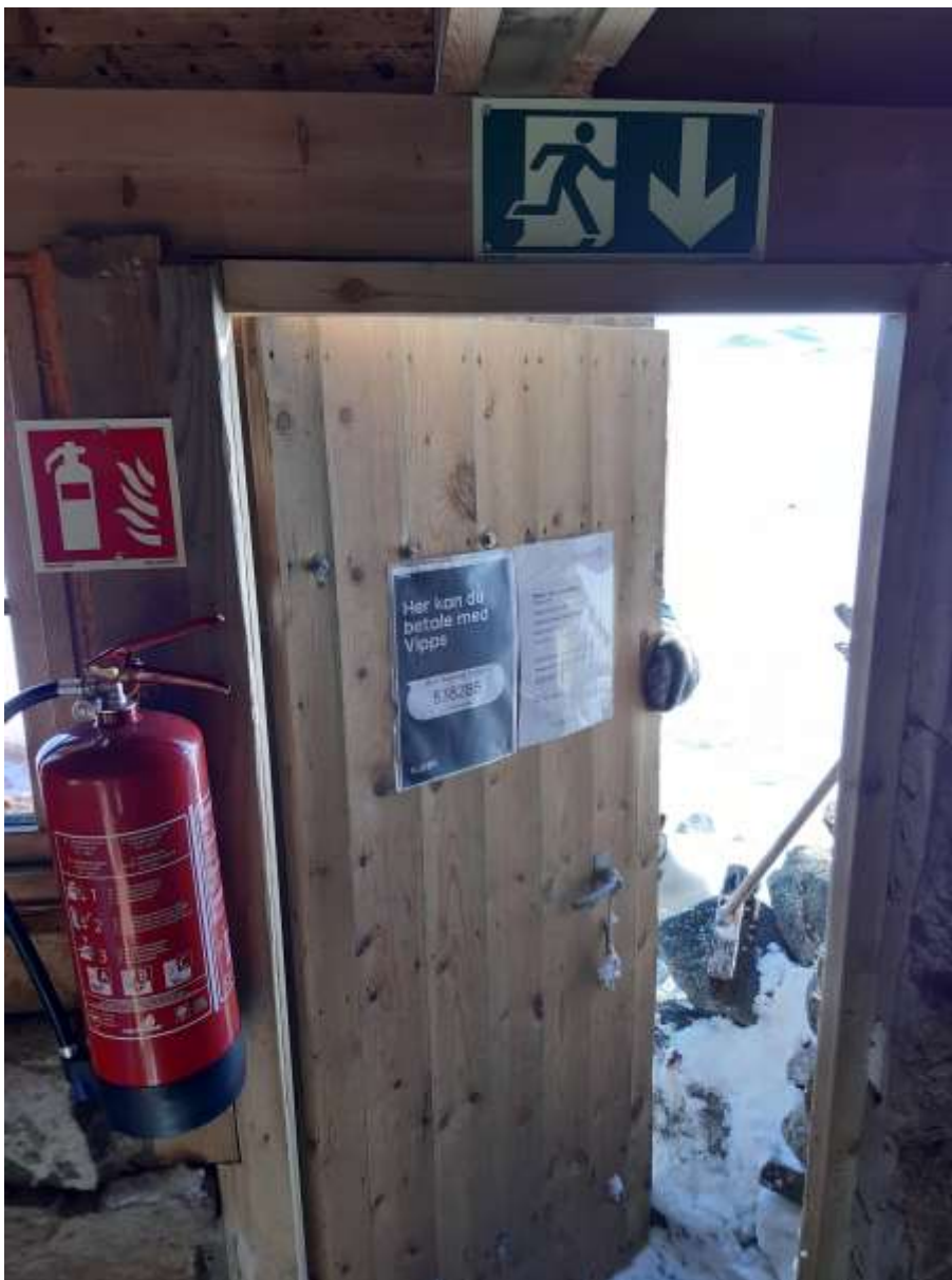
Brannsikkerhetstiltak med merking av røatingsveg og oppsett av brannslukningsapparat og røykvarslere i steinbuene. Dette er et bilde fra Skyttarbulægeret.
