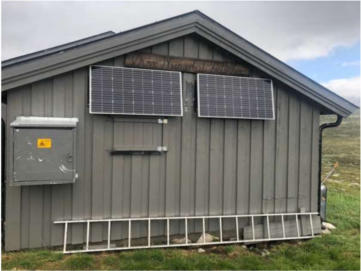
Solcellepanelene på Vegarhovd og Jegerbu ble byttet ut. På Vegarhovd var panelene knust mest sannsynlig pga snømengden vinteren 2020.
