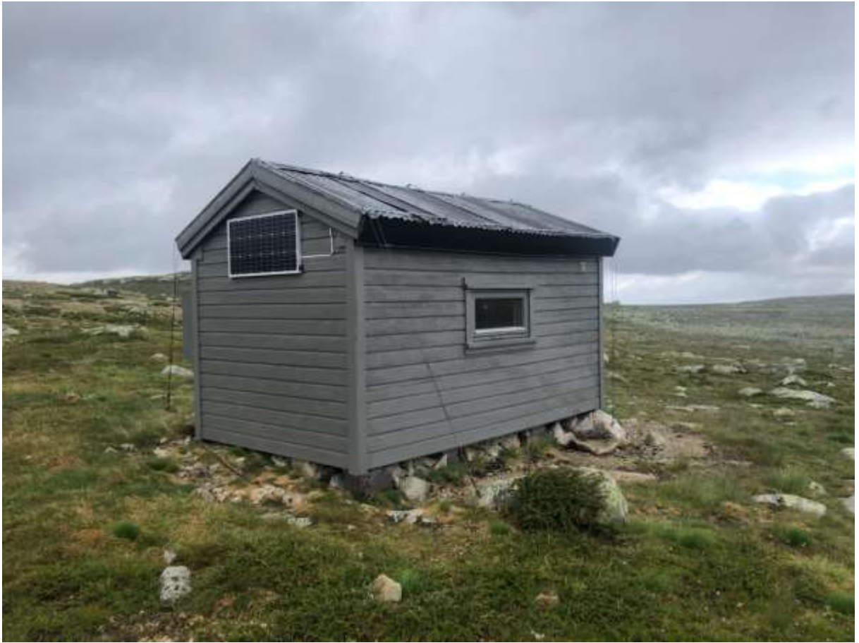
Det ble montert et lite solcelleanlegg på Furtebua.
