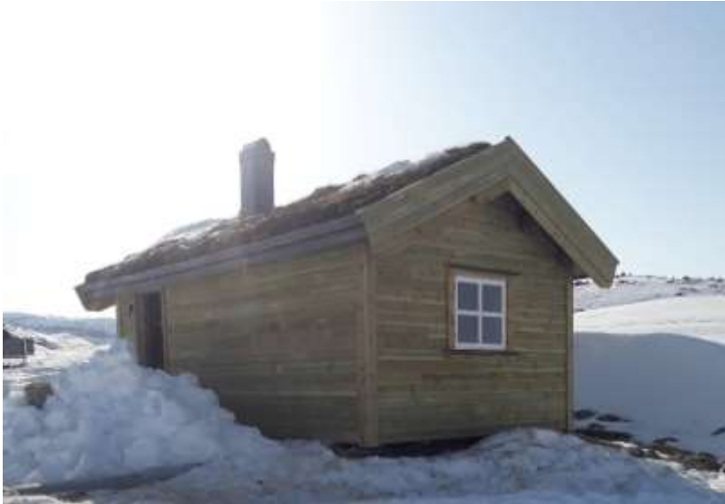
Fjelloppsynet bytta kledning og glas på Ripsebu på Osafjellet. Foto HF, Sveinung H. Olsnes
